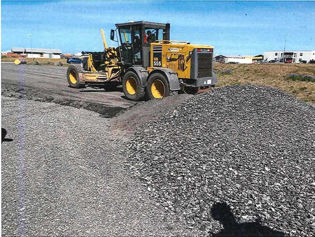
Mynd 1. Fræst malbik jafnað út á bílastæði í Reykjanesbæ. Engin frekar úrvinnsla fer fram. Hér verður endanleg yfirborð því einskonar millistig milli malarlitlags og malbiks.
