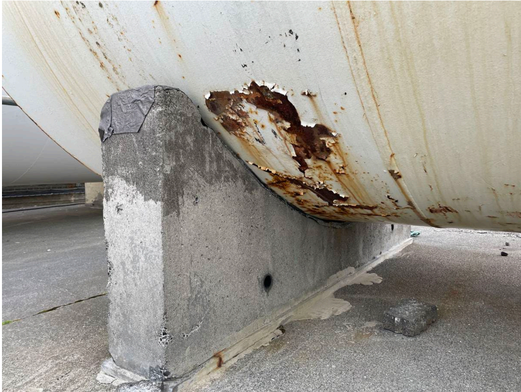
Mynd 3. Umfar virðist ótært við fundament.
