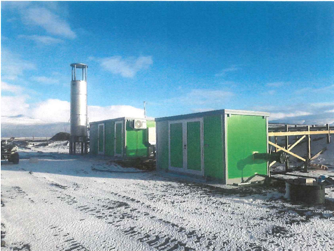
Gasbrennslustöð í Stekkjarvík
