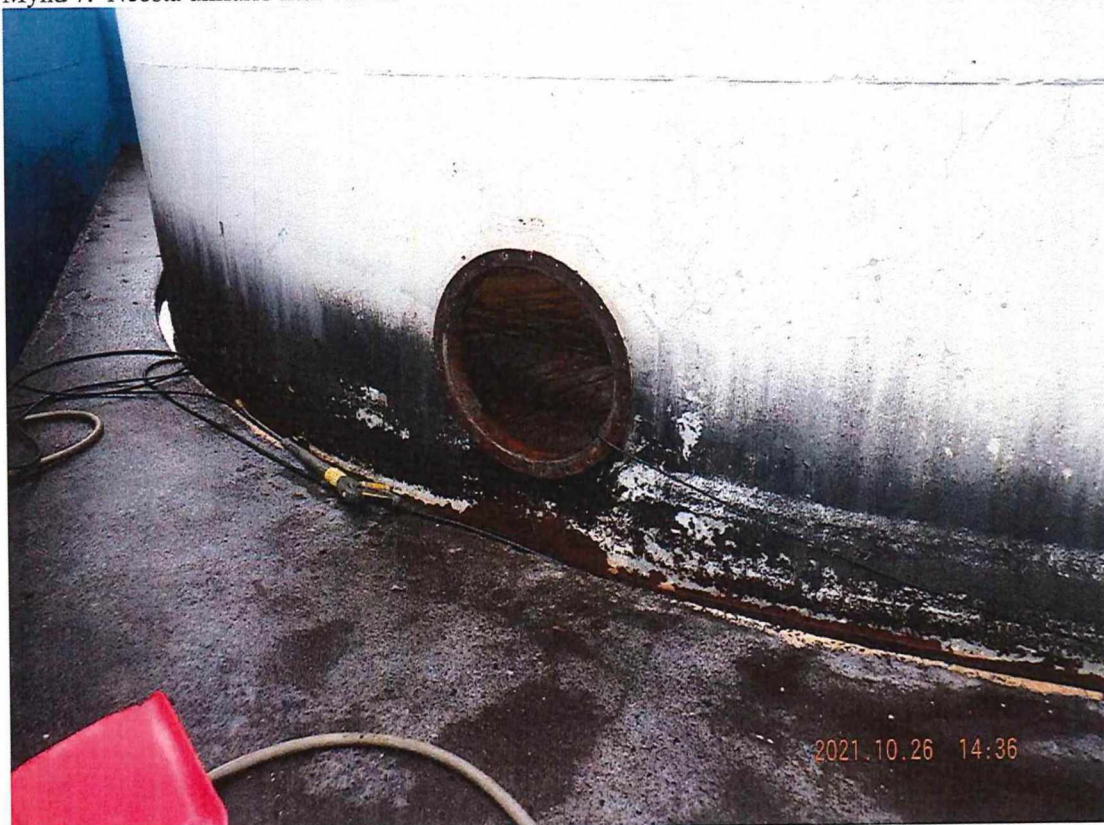
Mynd 8. Mannop geymis. Ástand málningar er misjafnt við kverk geymis og ryð farið að myndast víða án verulegrar tæringar.
