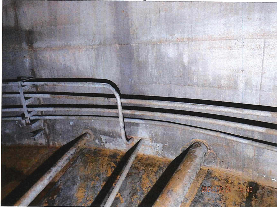
Mynd 2. Gólf og neðsta umfar er ómálað en án tæringar.
