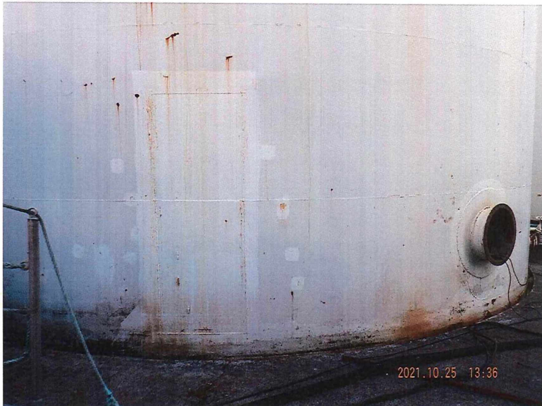
Mynd 7. Neðsta umfarið ágætlega vel út að utan.
