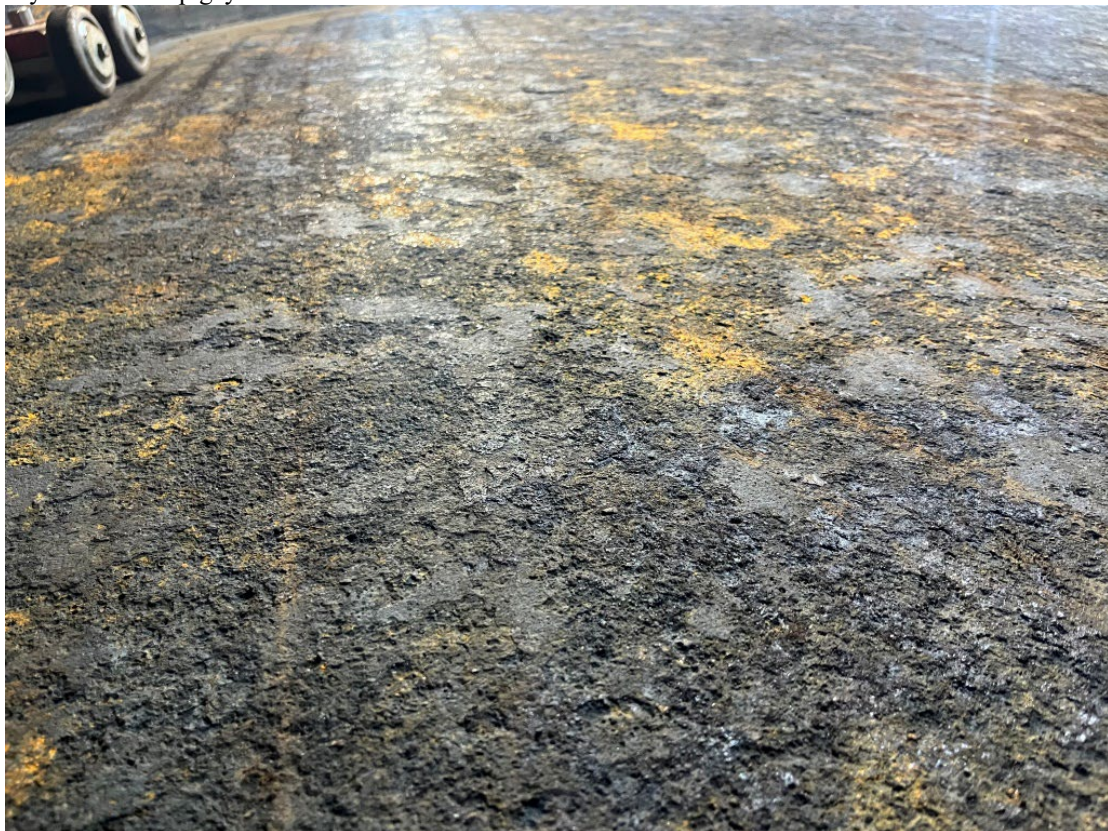
Mynd 2. Gólf geymis er óvarið og markað af tæringu. ( 1-2mm djúpir pyttir )
