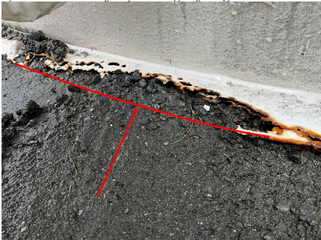
Mynd 6. Undir löndunarlokanum hefur verið tvískinnungur að utan sem er að tærast burt. Útkantur plötunar er nánarst horfinn.
