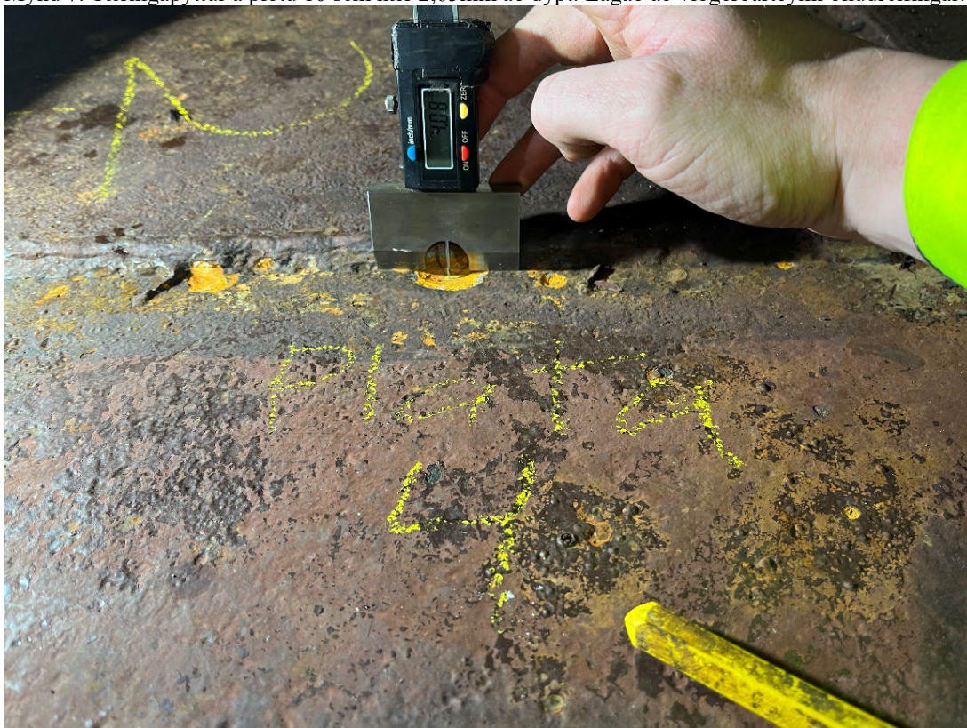
Mynd 8. Tæringapyttur á plötu 4 sem nær 4 mm að dýpt. Lagað að viðgerðarteymi olíudreifingar.
