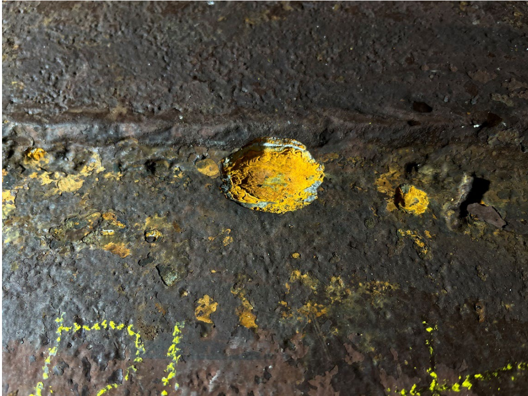
Mynd 9. Tæringapyttur á plötu 4 sem nær 4 mm að dýpt. Lagað að viðgerðarteymi olíudreifingar.
