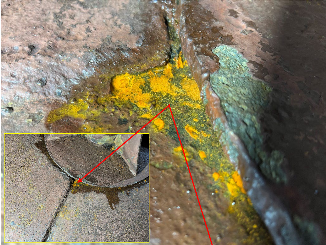
Myndir 11-12. Tæringapyttir við platta fyrir súlu. sem ná 2,6 og 3.3 mm að dýpt. Lagað að viðgerðarteymi olíudreifingar.
