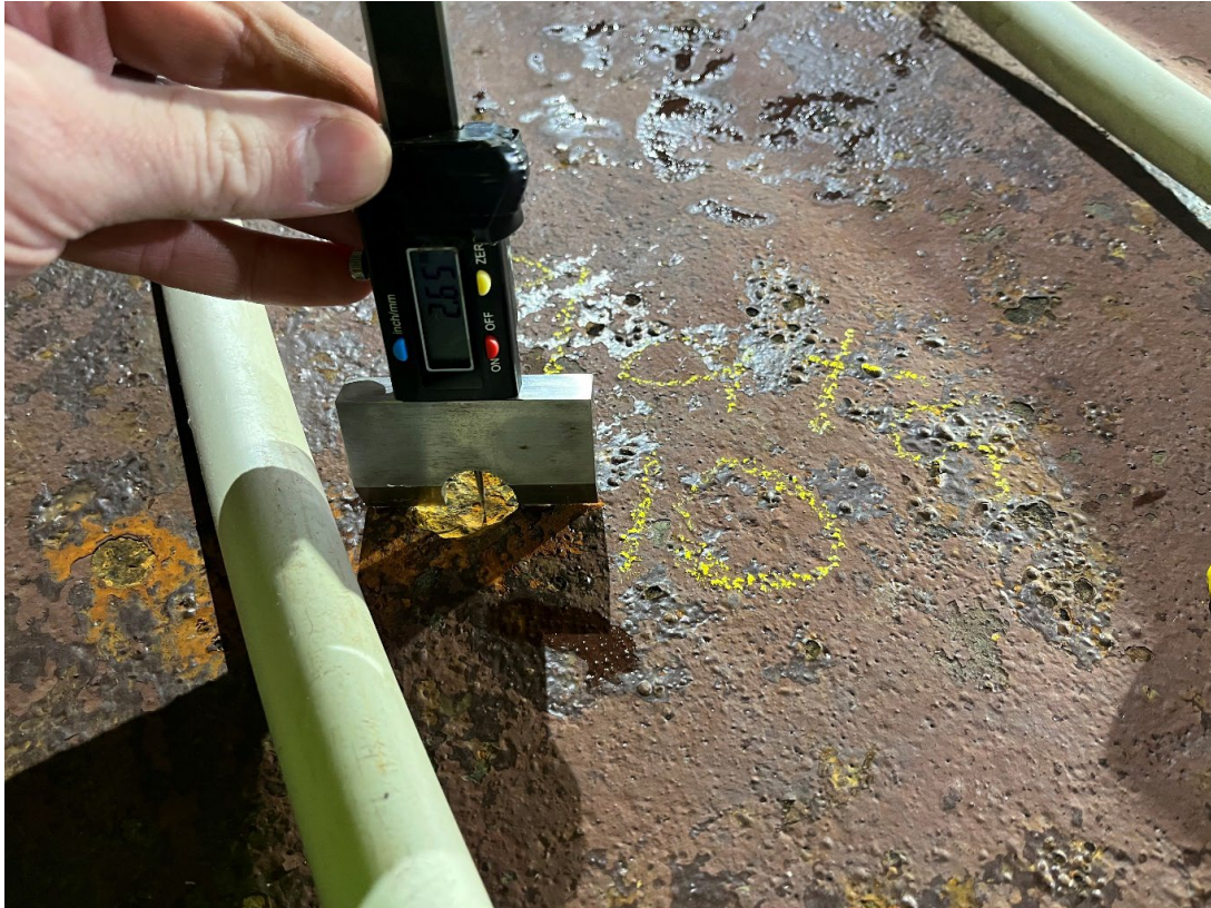
Mynd 7. Tæringapyttur á plötu 10 sem nær 2,65mm að dýpt. Lagað að viðgerðarteymi olíudreifingar.
