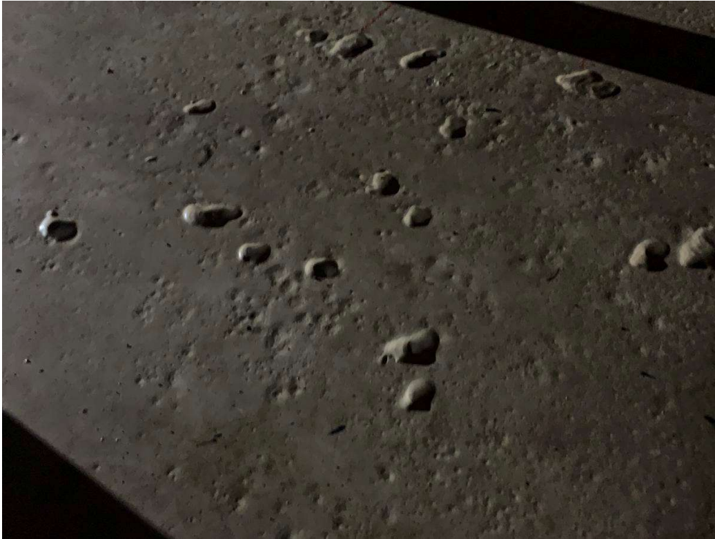
Mynd 2. Víða fundust ummerki tæringar frá fyrri tíð. ( 1 - 1,5mm djúpar ) og einnig gamlar viðgerðir. Geymir hefur verið sandblásin og málaður ( gólf og hluti af neðsta umfari).
