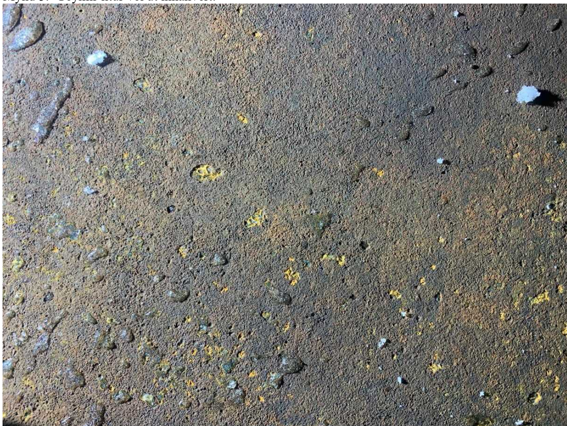
Mynd 6. Gólf er alsett tæringu en þó ekki alvarlegri.
