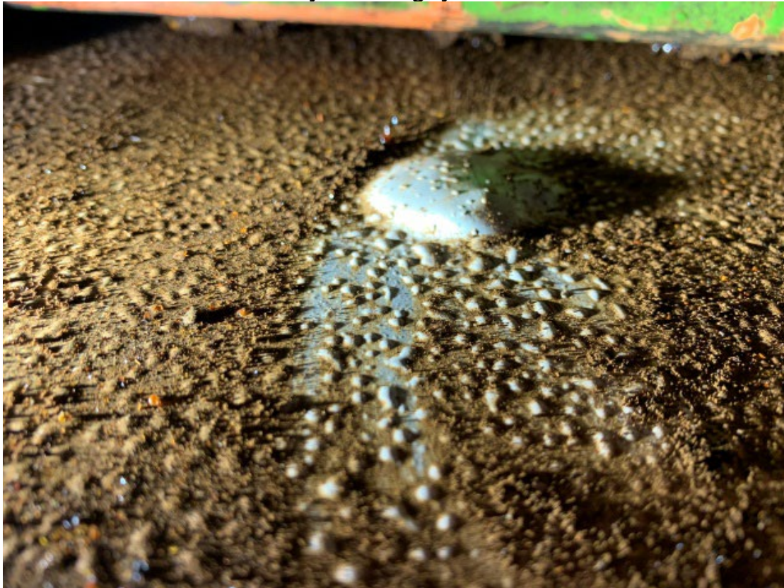
Mynd 1. Gólf geymis. Málning geymis er asett loftbólum.
