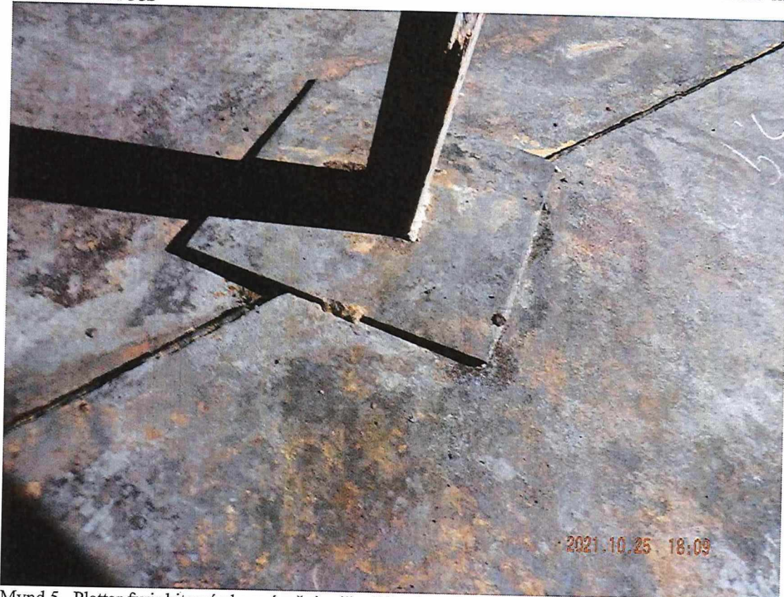
Mynd 5. Plattar fyrir hitaspíral eru ósoðnir við gólf og þar að auki ryðfrír en það getur skapað tæringarvandamál.
