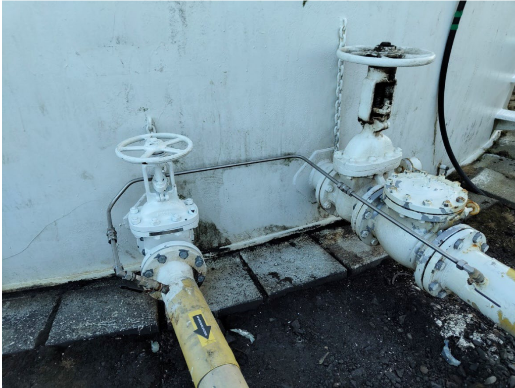
Mynd 3. Engin tæring í kring um inn/úttök, neðsta brún tanks að utan góð.
